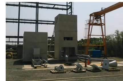
千葉工場 ボルテックスバルブ実験場
